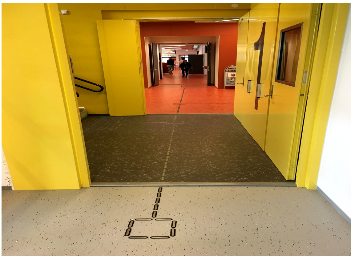
FARGESONER: Fargede soner veileder. Korridoren nærmest har grått gulv med hvite spetter, mens bi-trappeløpet har samme belegg i en mørkere farge mot gule vegger og dører. En rød allmenning, en frisone, fører inn til kantineområdet med samme gulv.
