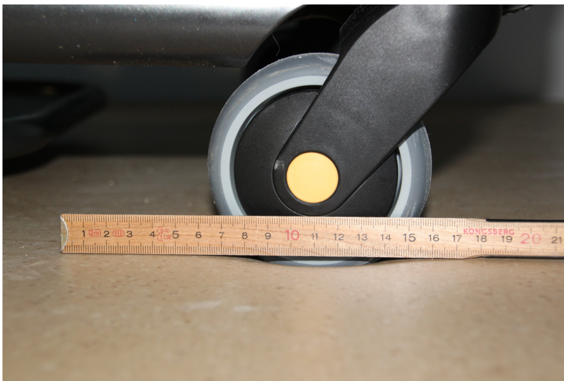
FOR MYKT?: For stor demping og svikt i gulvet gjør det vanskelig å trille vogner og senger over gulvet. Foto: Arne Nesje/SINTEF
