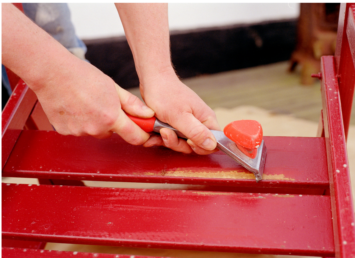
Gammel løstsittende maling skrapes vekk før et nytt strøk påføres. Foto: Nordsjö
