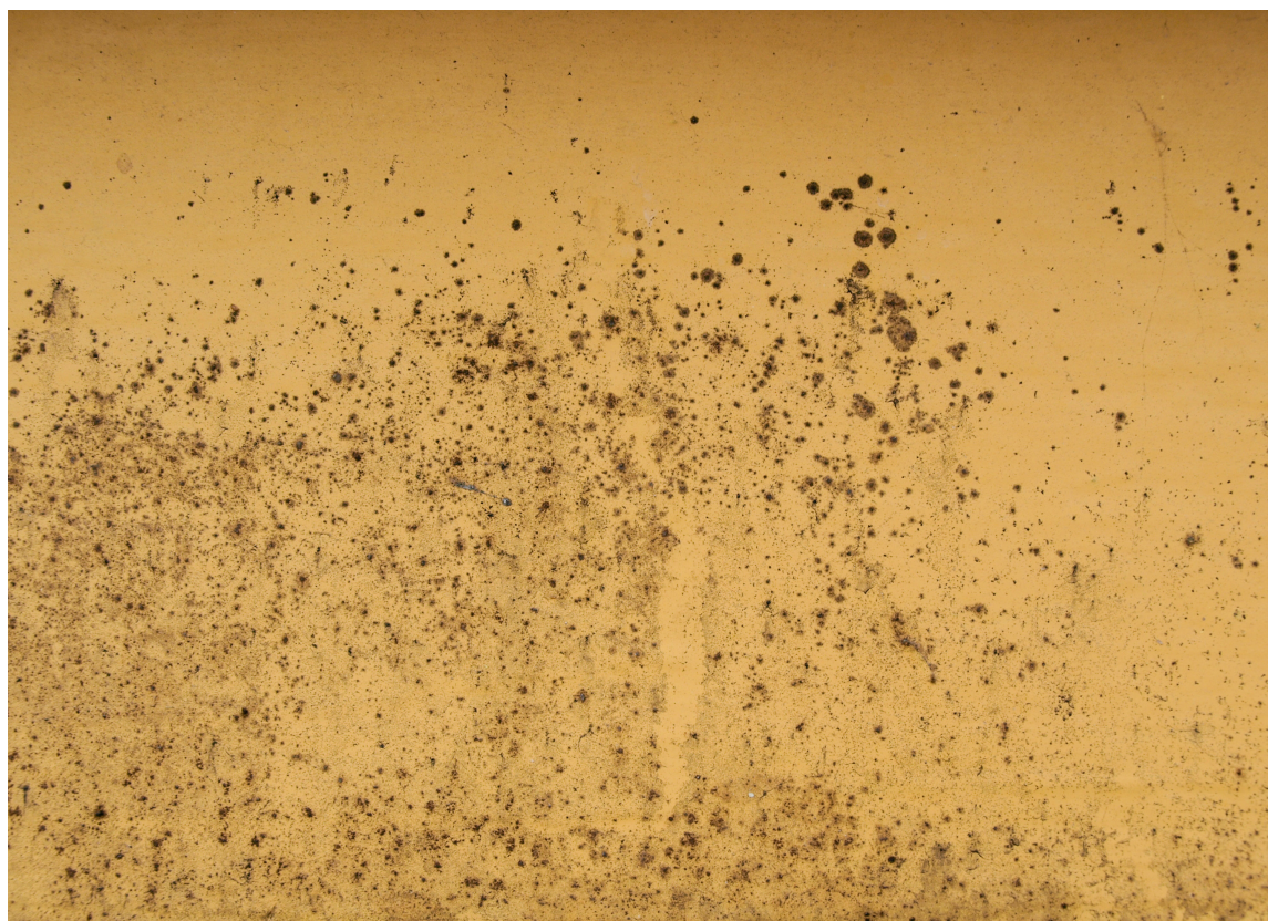
RÅTEFARE: Svertesopp lever på overflatene, og kan bane vei for råde.
