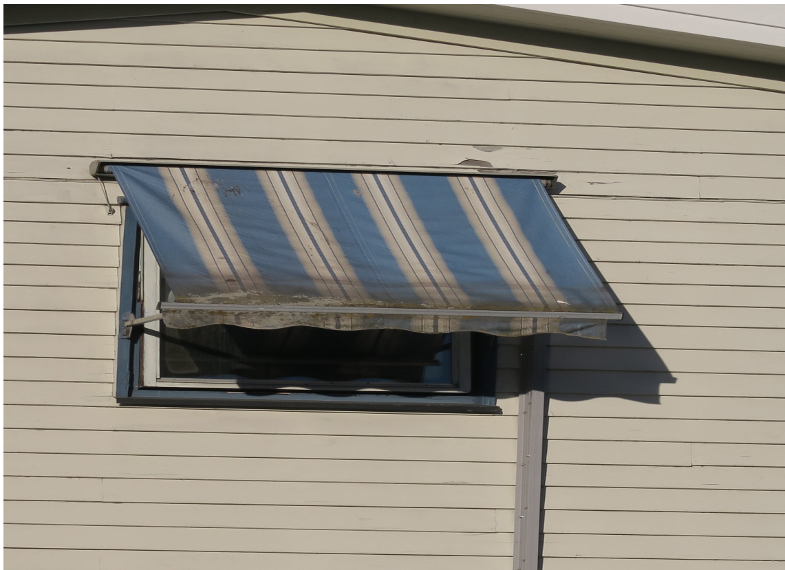
Veistøv, sot, sur nedbør og smuss tærer på husets vinger. For at de skal holdes pene, må de vaskes sommer og høst.
