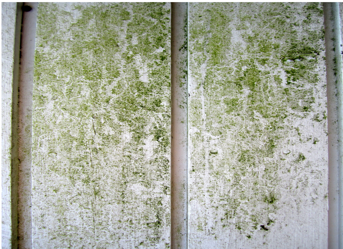
GRØNSKE oppstår fordi fukt blir stående på fasaden.
