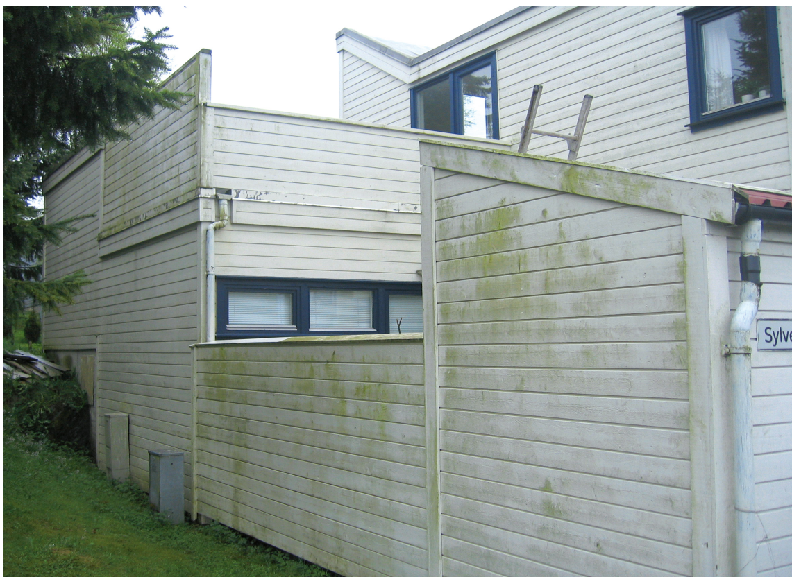
Vegger mot nord er mer utsatt for begroing, mens malingen på vegger mot sør- og øst slites mer.
