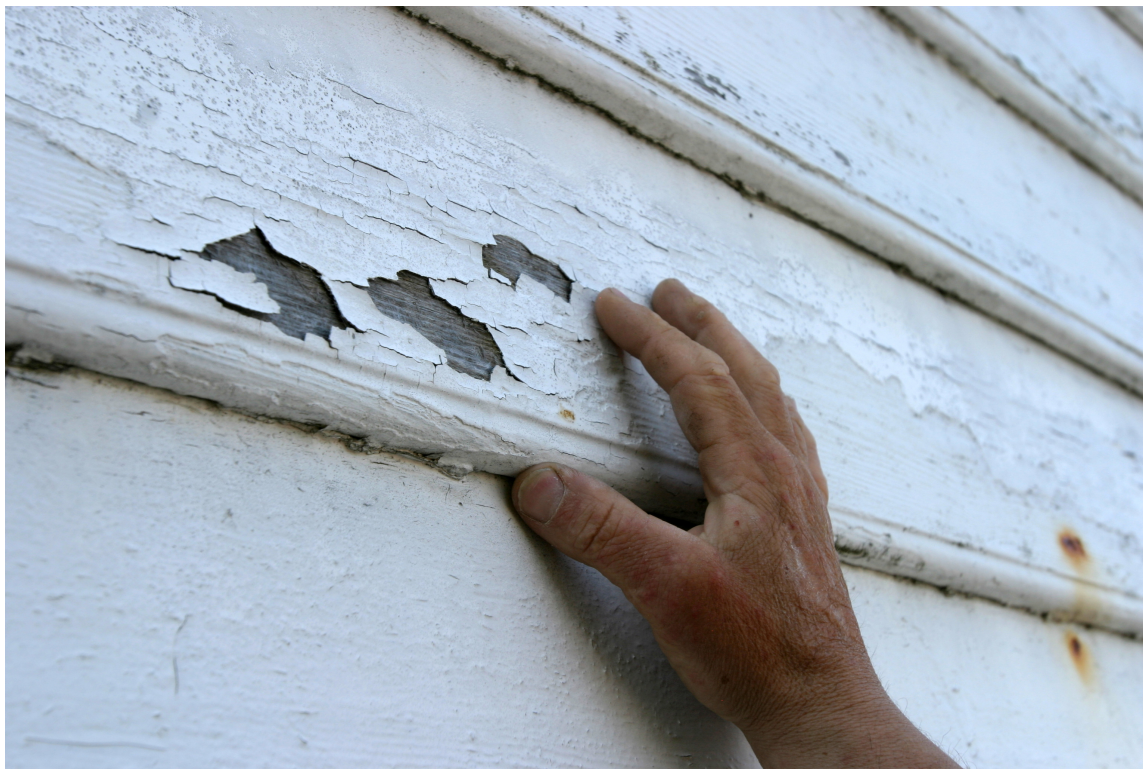
Går slitasjen for langt, holder det ikke med å flekke på skadene og vedlikeholdsarbeidet blir mer omfattende. Foto: Harald Sola Berentsen/ifi.no
