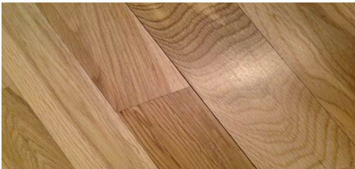
Høy gulvvarme kombinert med lav relativ fuktighet kan øke faren for sprekker i tregulvet, slik som på dette bildet.
