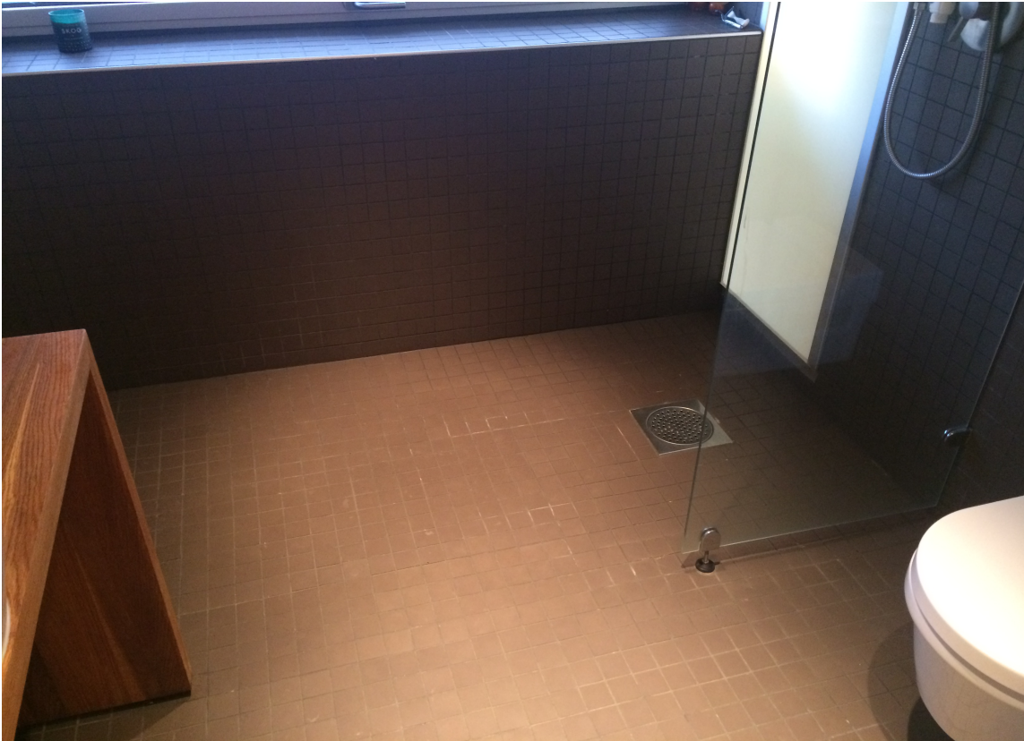
Misfargede fuger kan ødelegge mye av totalinntrykket på et ellers pent bad.
