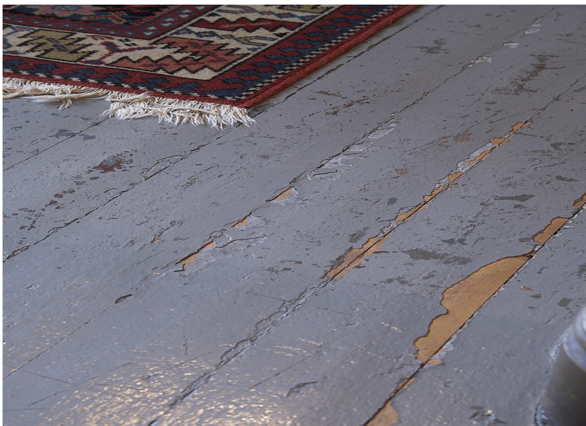
Det lønner seg å reparere skader med en gang det blir hull på malingsfilmen.
