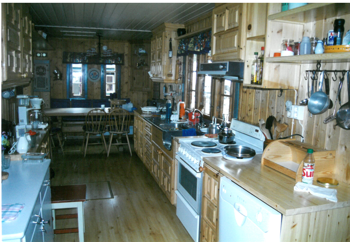
Kjøkkenet før. Tak, vegger og gulv grodde nærmest sammen.
