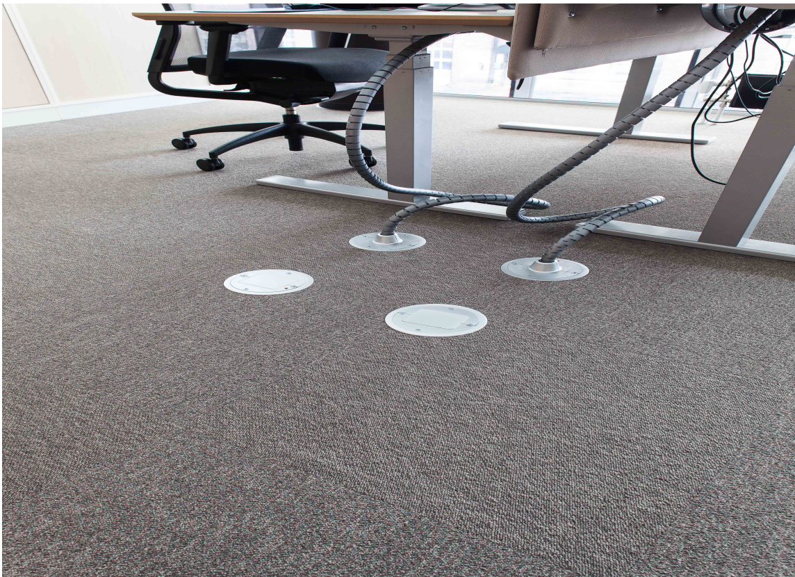
Kontorlandskapene er utstyrt med installasjonsgulv som gir utstrakt fleksibilitet for kabelstrekking – ikke minst for plassering av datautstyr.
