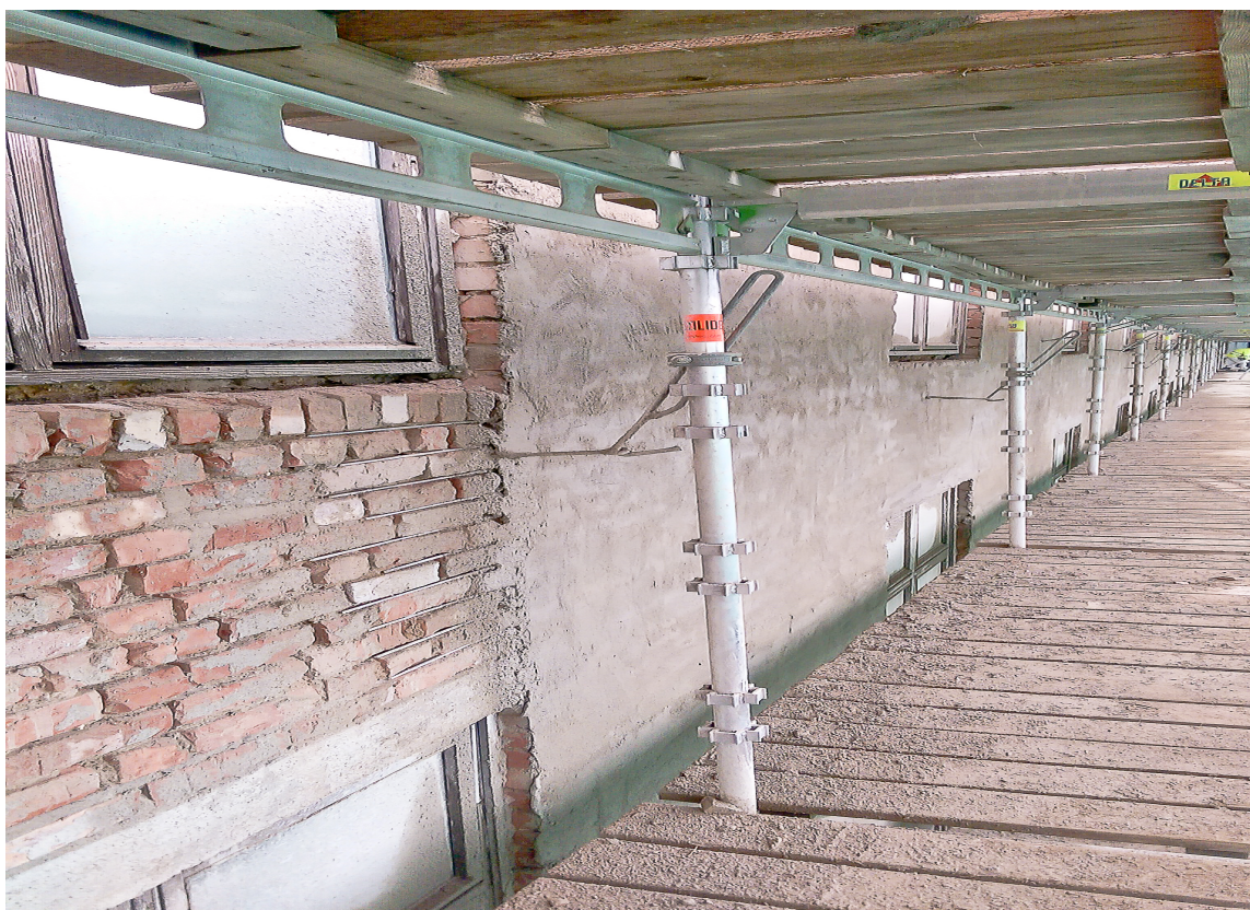
Etter at den gamle pussen ble hugd ned, måtte telgkonstruksjonen utbedres og ny avretting og puss påføres.
