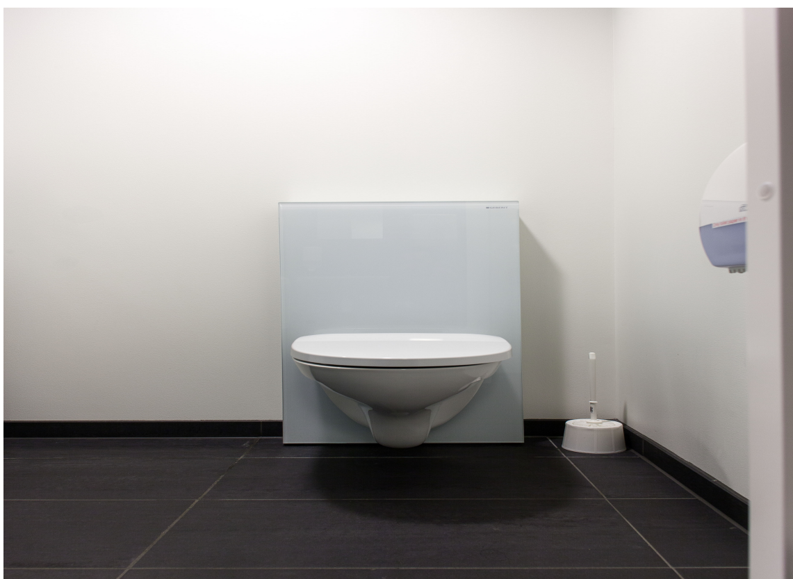
Subsea 7 følger også med på teknologiutviklingen når det gjelder toaletter. Her har man benyttet Geberit Monolith, med en praktisk sisterneløsning og vegghengt toalett.
