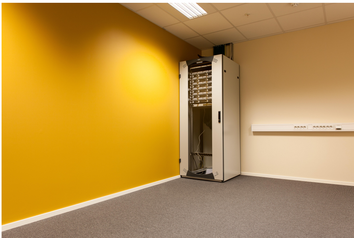
Det brukes også friske farger på veggene i tekniske rom.
