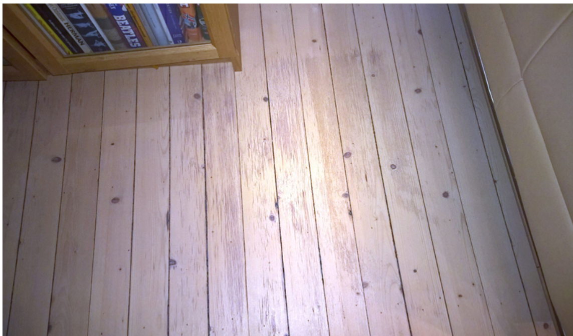
Flekken er inn under lakken og misfarget selve golvplankene.
