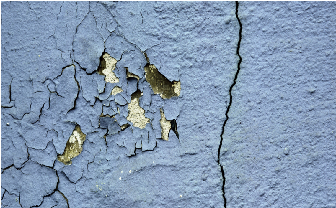
Sprekkdannelse og avskalling bør undersøkes nærmere.
