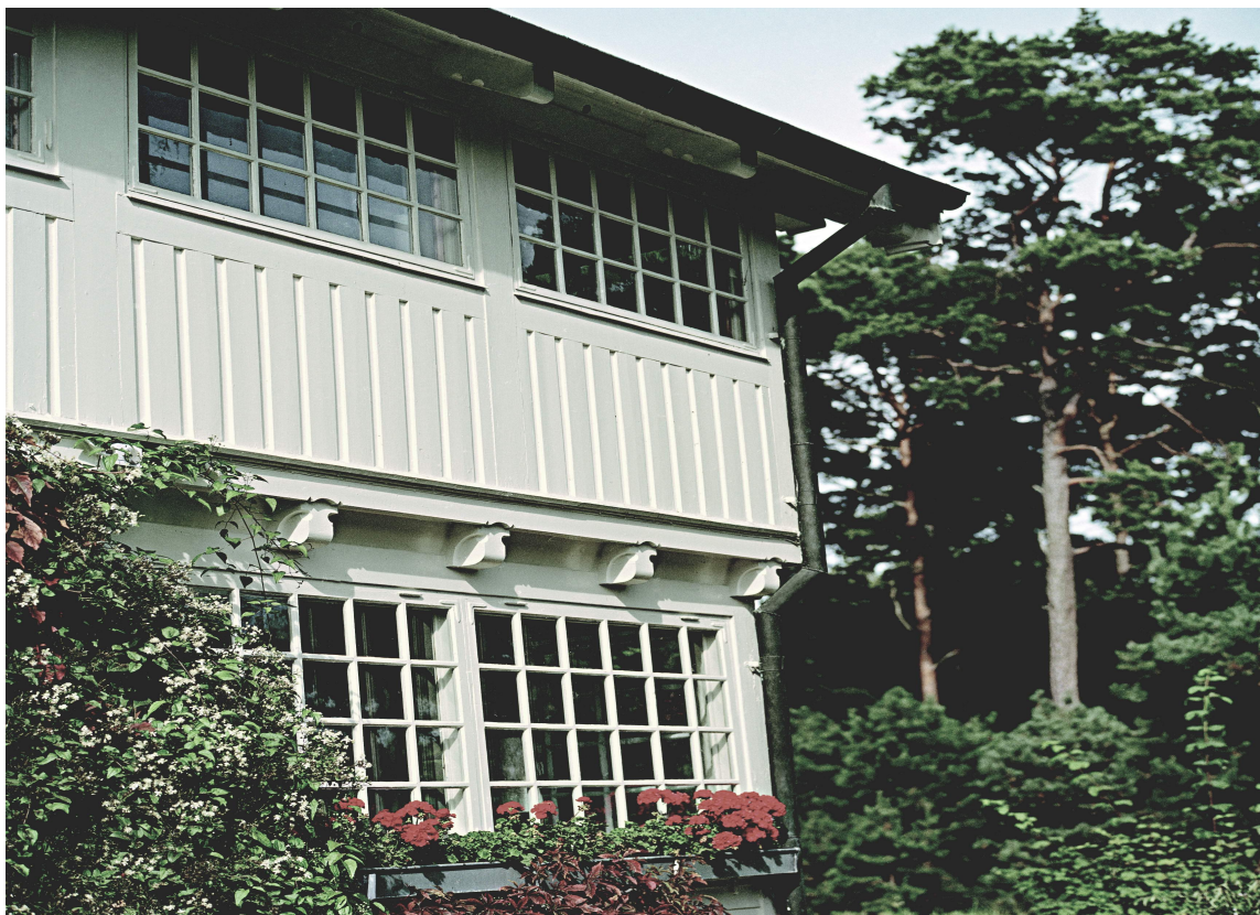
Nærliggende vegetasjon kan spille en rolle.
