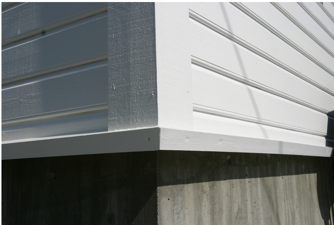
Nederste del av kledningen er spesielt utsatt for fukt.
