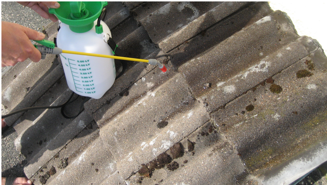
Alger og mose må fjernes fra taksteinene
