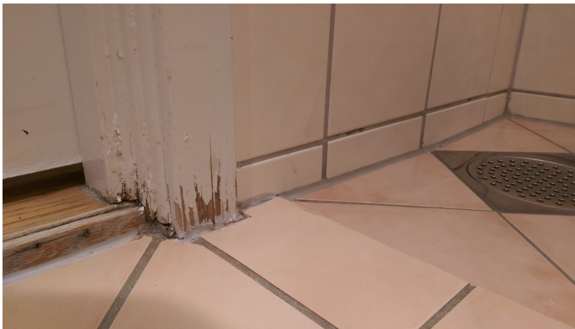
Dette skjer med listverk som utsettes for vann. Ikke spesielt innbydende.
