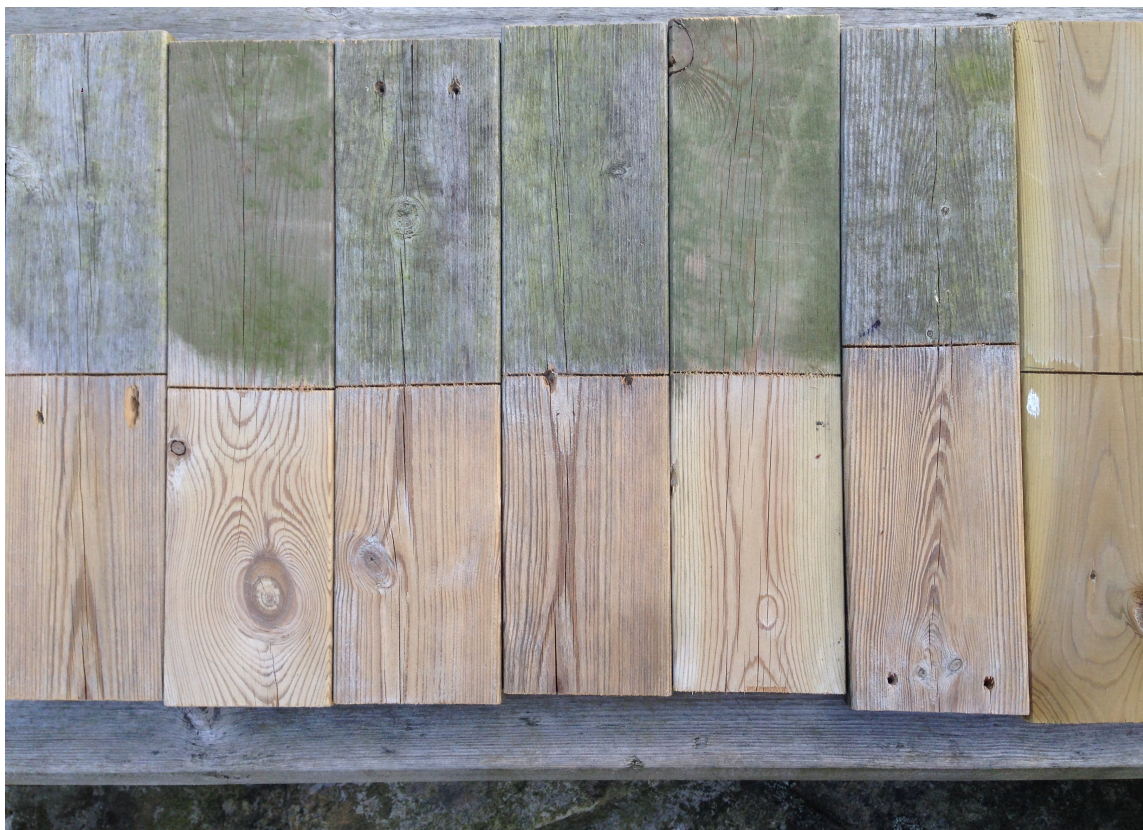
Øverst ser vi terrassebord som ikke er behandlet, mens de nederste er nyrenset og beskyttet med Wood Care-systemet.
