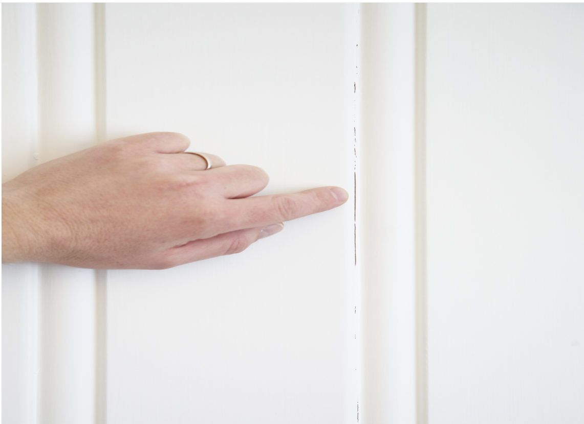
Krympesprekker er skjemmende på en malt vegg.
