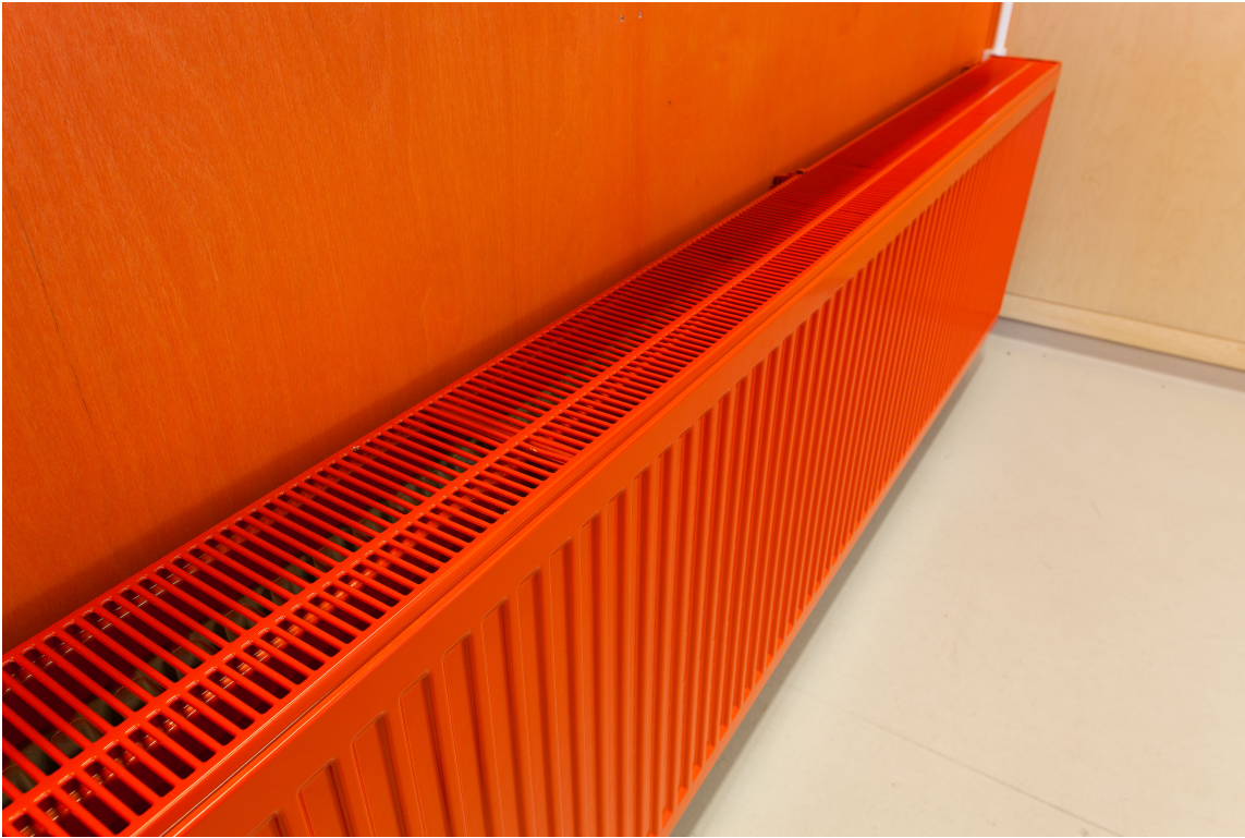
Selv radiatorene har fått riktig farge.
