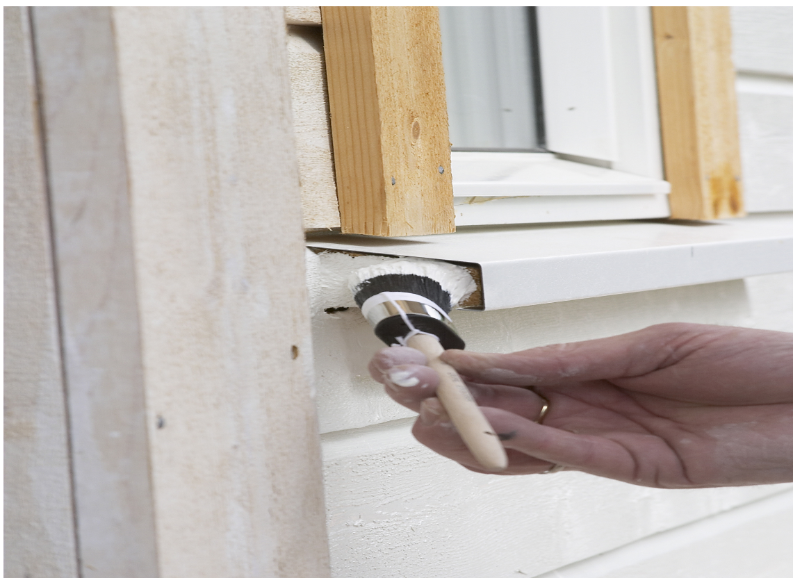
Endeved må grunnes ved montering.
