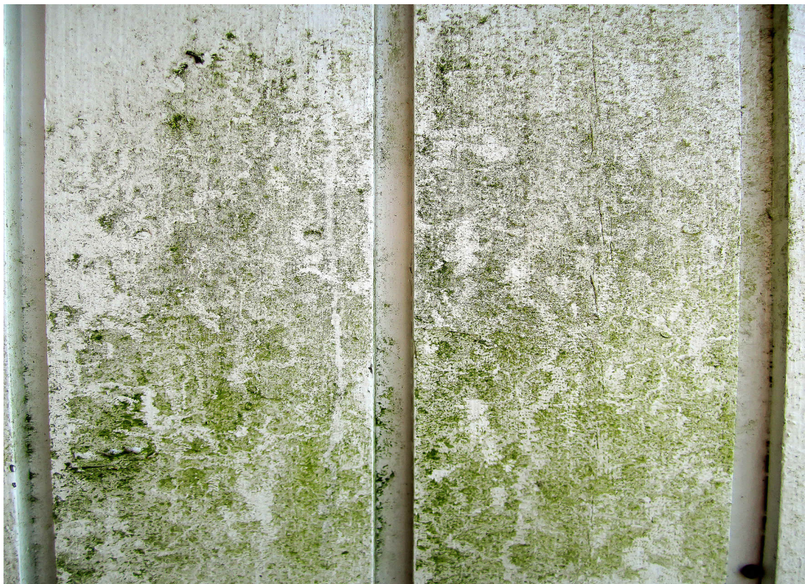
Det ser ikke bra ut, og er heller ikke bra for husveggene. Vask veggen!
