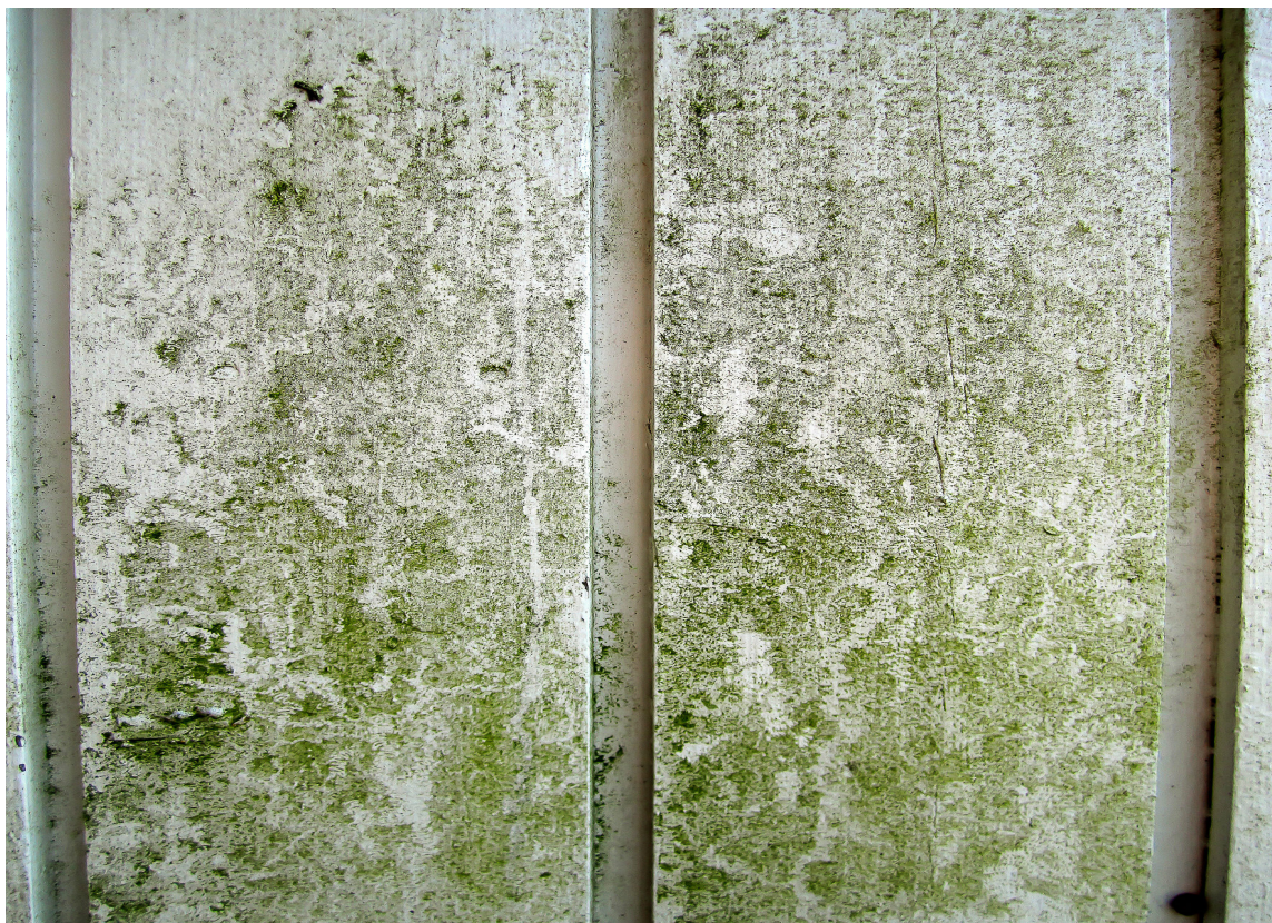
Begroing er lite pent, og dessuten skadelig for fasaden.
