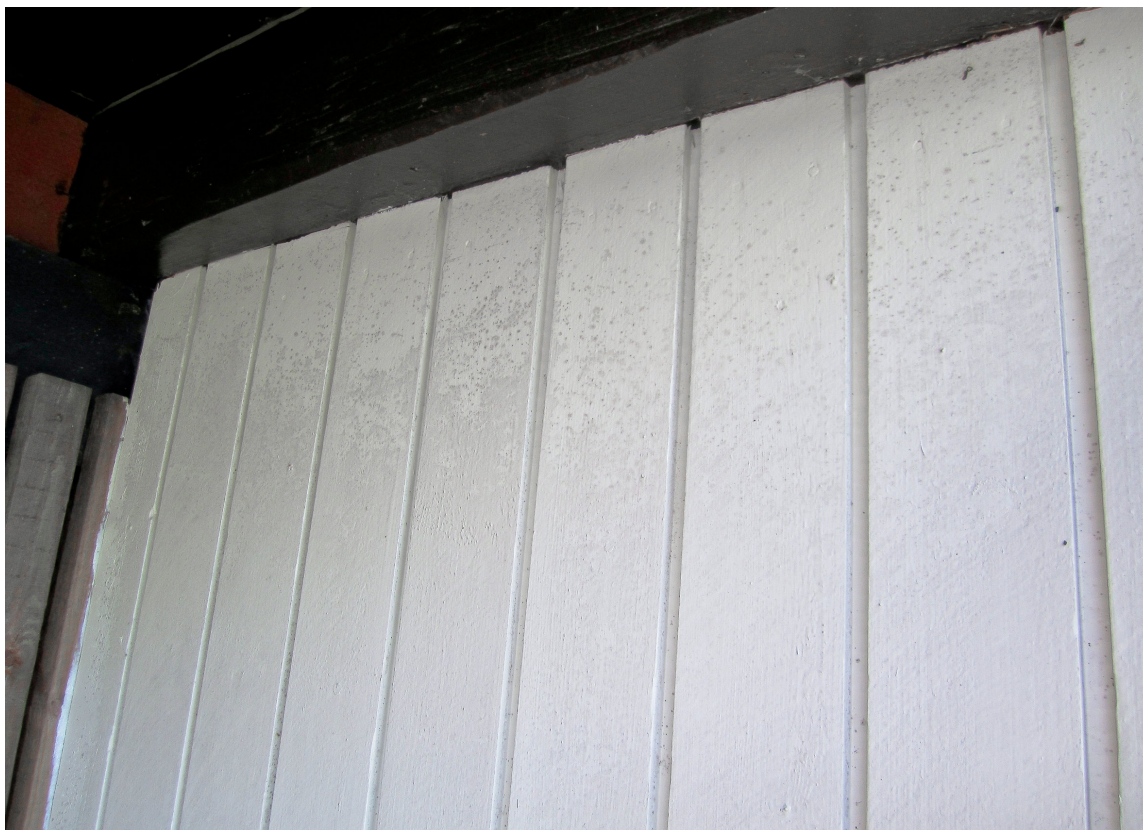
Saumfar veggen, og oppdag skader i tide!
