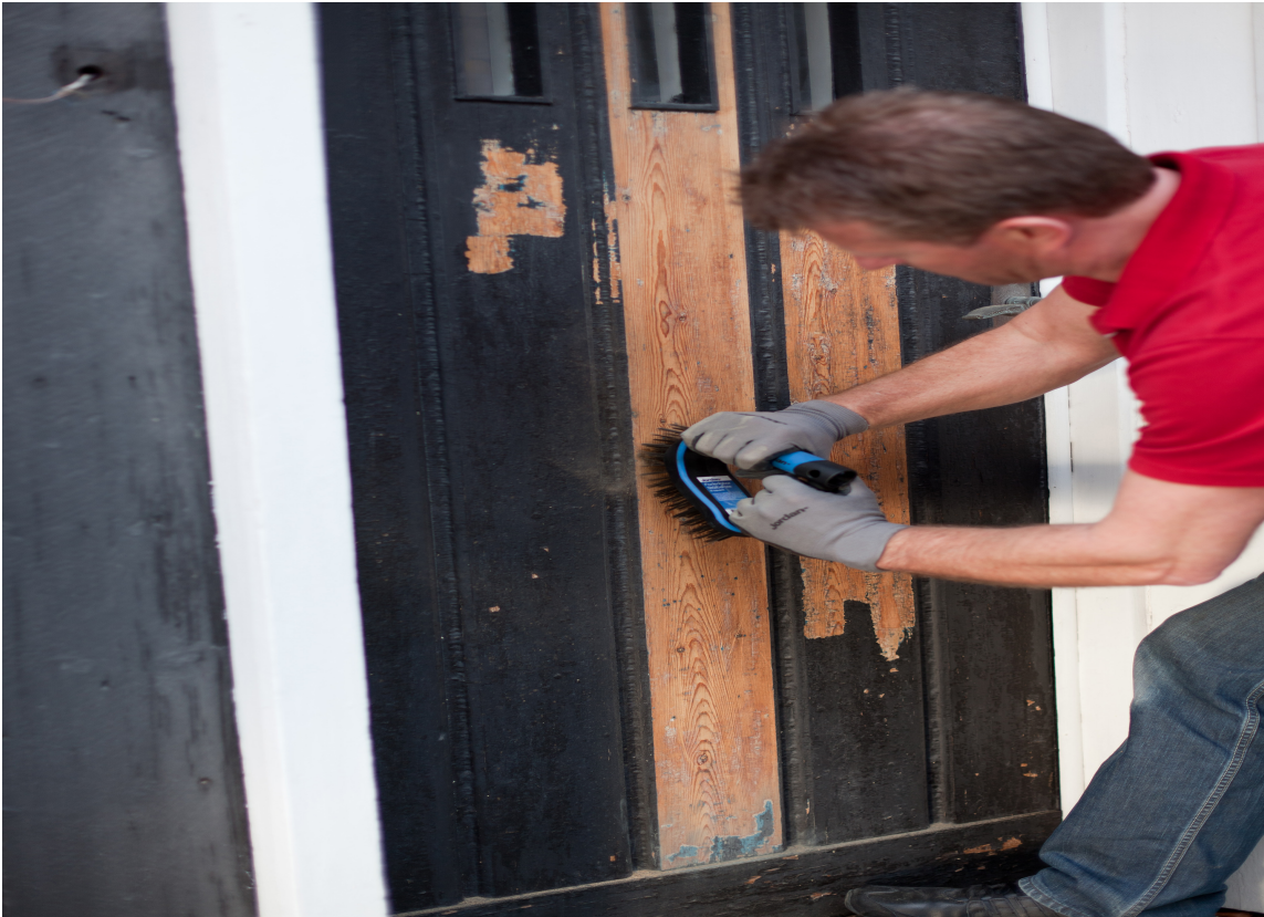
SKÅNSOM: En stålbørste fjerner død ved, uten å skade eller ripe treverket.
